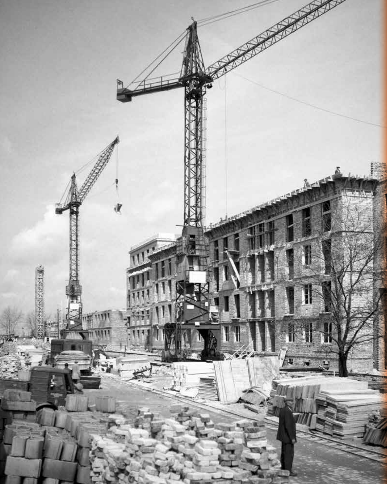
Budowa bloków osiedla Bielany I przy ulicy Kasprowicza, ok. 1955. Fot. Zbyszko Siemaszko/NAC
